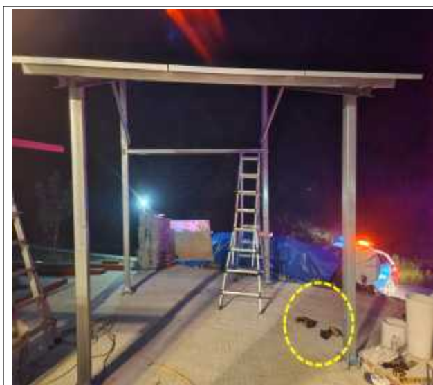
【사진 4】 사고 당시 공구의 위치
