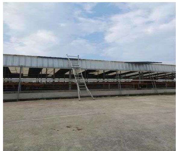
[사진4] 설치된 승강사다리
