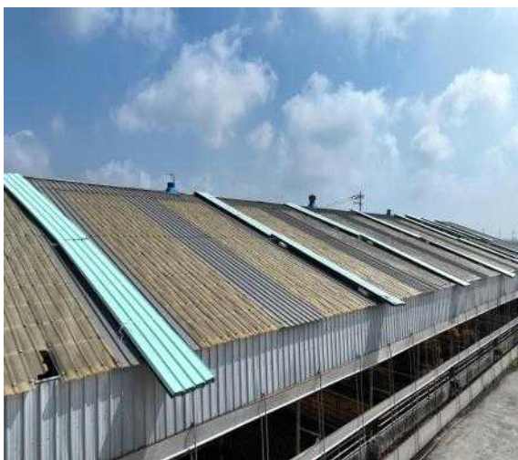
[사진11] 지붕 위 작업발판 및 안전대 부착설비 미설치
