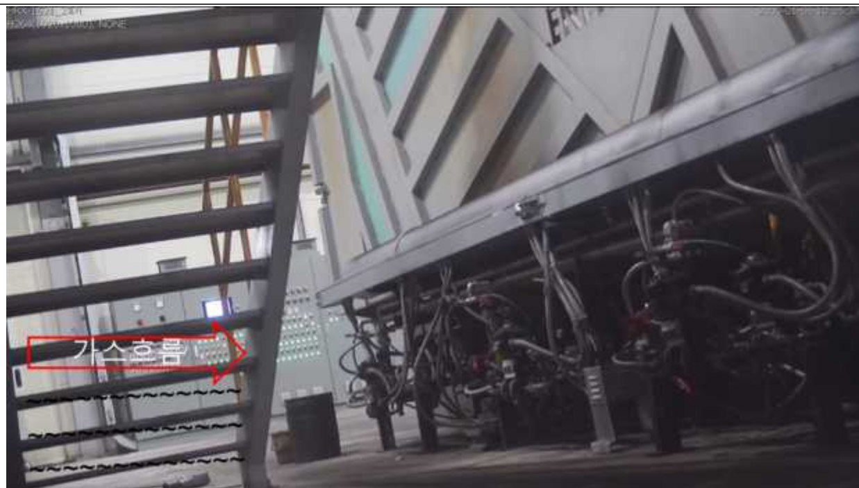
[사진 2] 3호기 문 개방 후 2호기로 방향으로의 가스 흐름
